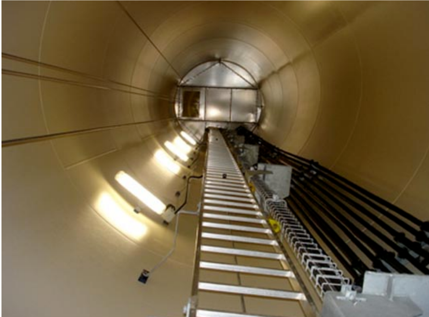
图10--塔架内部照片
